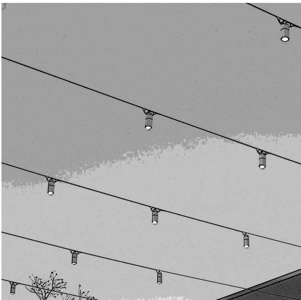
Figur 9.10-4 Exempel på kabelupphängning med sling.
